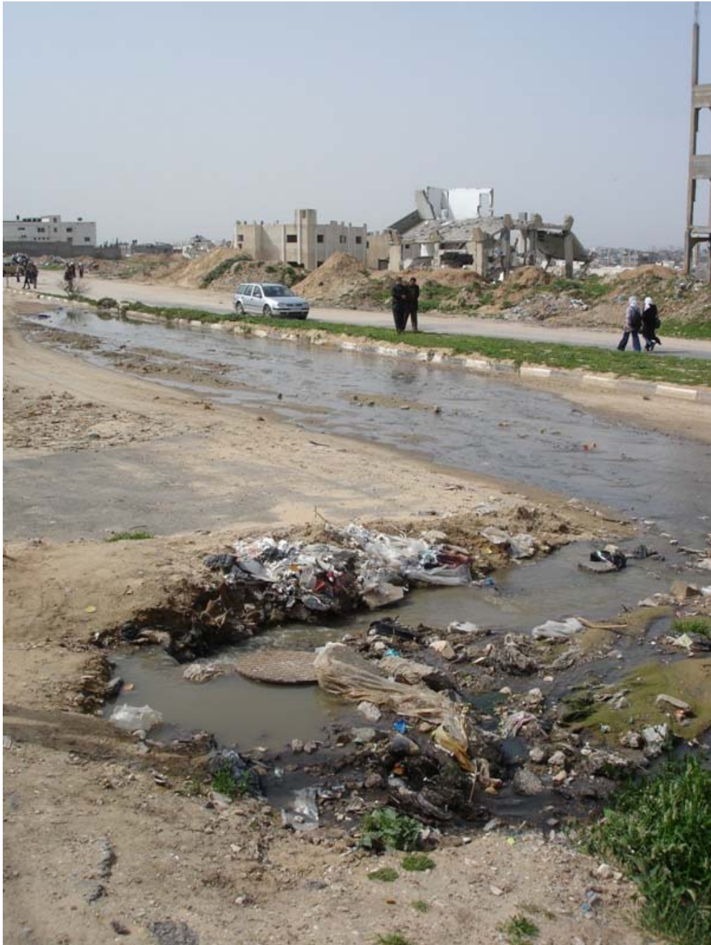
Main Street Beit Hanoun – Beit Lahya. Bomb crater damaged Sewerage pipeline
